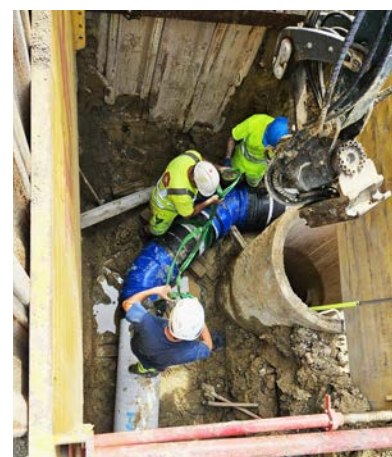
Transportleitung Einfahrt Reservoir Mötteli
