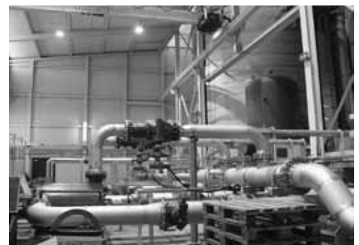
Innenansicht des Hochdruckpumpwerkes im Rietli
