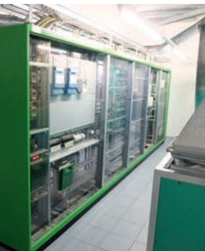
Die Heizzentrale im Oberstufenzentrum ist erneuert.
