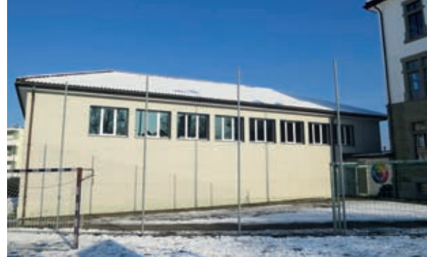
Die alte Rosenackerturnhalle weist grosse energetische Mängel auf.
