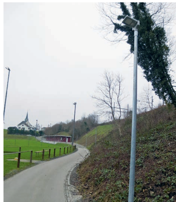
Der Dammweg erhielt eine neue LED-Strassenbeleuchtung.
