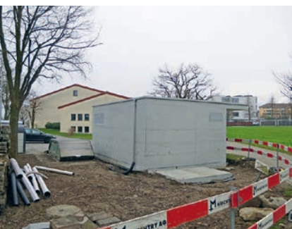
Die neuen bzw. geplanten Photovoltaikanlagen auf den Dächern des TZM und der Wartegghalle machten den Bau einer neuen Trafostation nötig. Diese erhöht zusätzlich die Versorgungssicherheit in diesem Gebiet.
